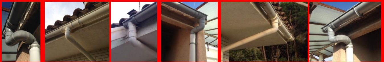
Juntas y pequeñas fisuras en canalones
